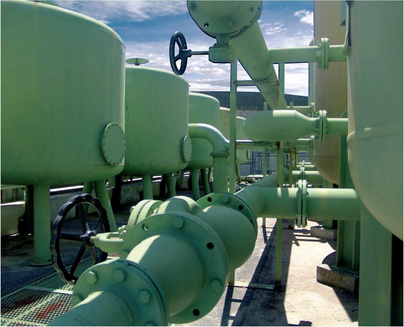
Estação de Tratamento de Água
